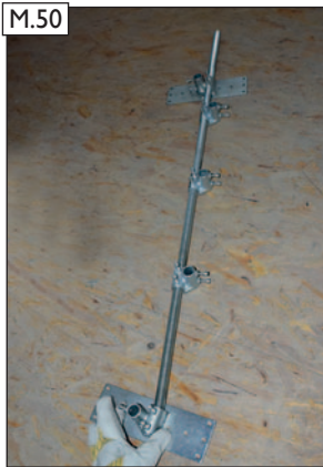
M.50 Zweiten Schornsteinhalter vorbereiten. Spannkreuze und Sparrenhalter lose auf die Gewindestange auffädeln.
